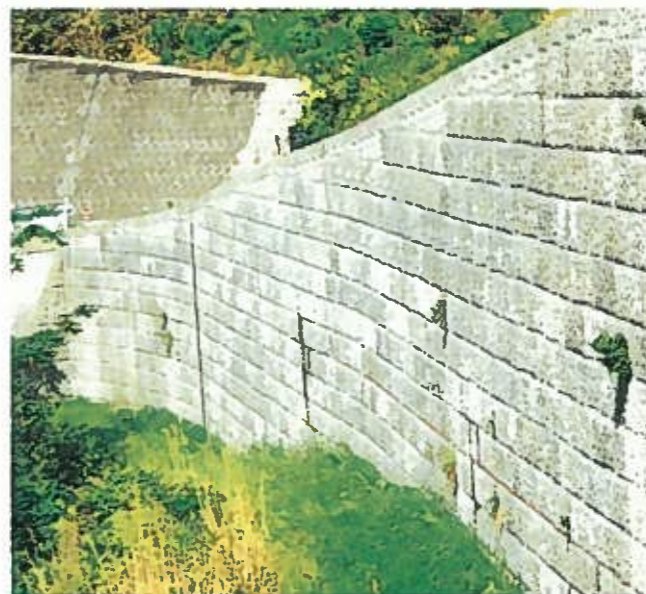
工事件名 一般県道雲仙千々石線 道路改良工事 施工場所 長崎県 施主 島原振興局 擁壁高(m) 8.9 面積(m 2 ) 582.00
