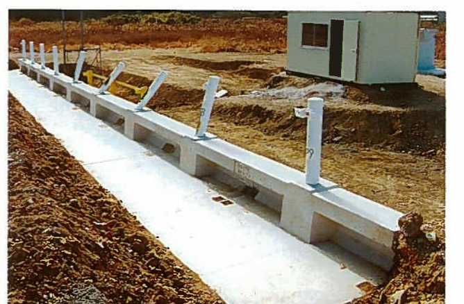
衝突後の状況 (補強土壁上)
