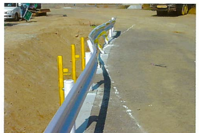
衝突後の状況 (直接基礎上)
